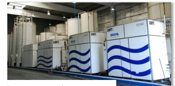
Leistungsstarke Emulsionsspaltanlage am Standort Ungarn
